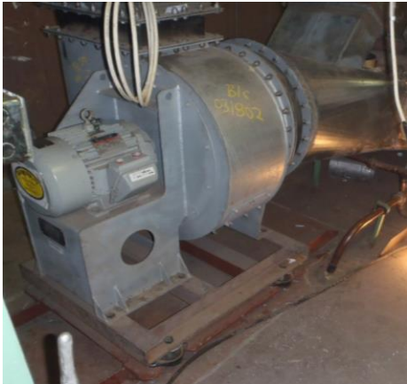
HVAC Fan Motor
